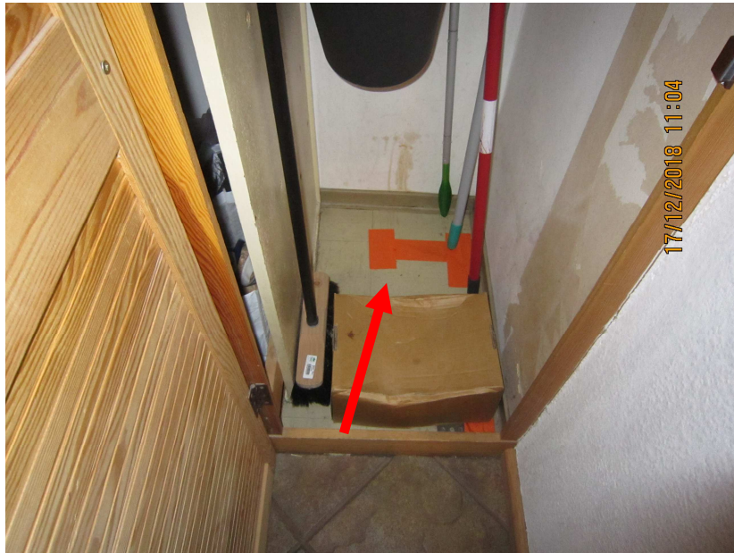
Bild 3. Verbliebener alter Bodenbelag in der Besenkammer
